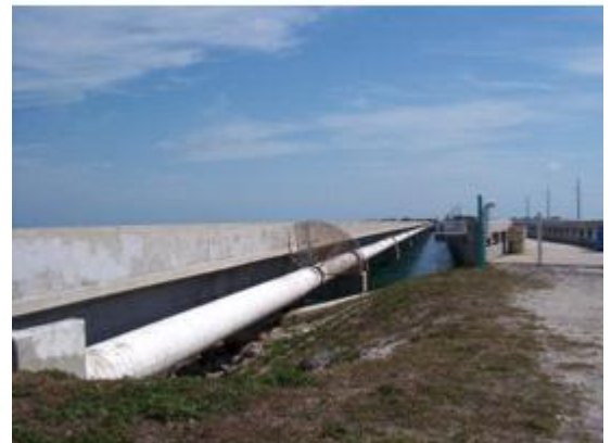
Trinkwasser-Leitung Florida Keys
