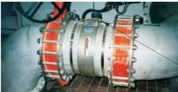
Kläranlage Frankfurt-Sindlingen El. Leitfähigkeit mittels externer Kabelbrücke (bauseits) STRAUB-FLEX 2LS als Ein- und Ausbaustück
